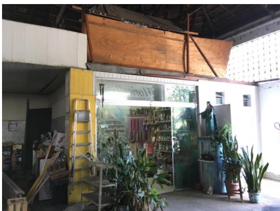
Foto 23 – Improvisação de cobertura com lonas.
