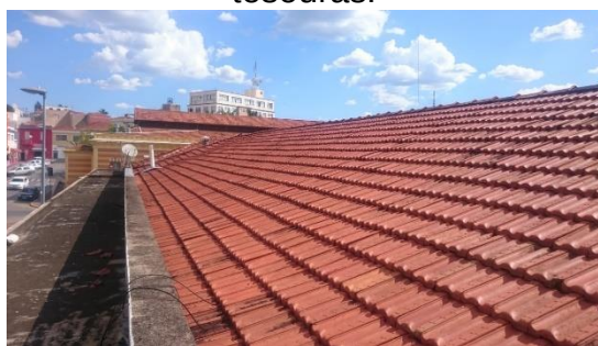
Foto 20 – Inexistência de rufos.
