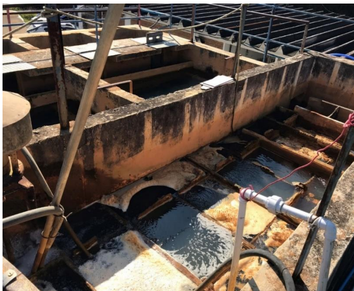
Figura 4. Sistema de flocculação
