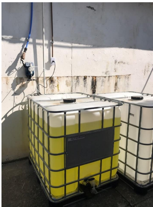
Figura 10. Tanque de hipoclorito de sódio e sistema de dosagem.
