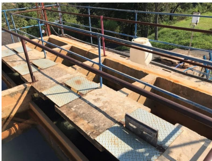
Figura 8. Vista dos quatro filtros existentes.
