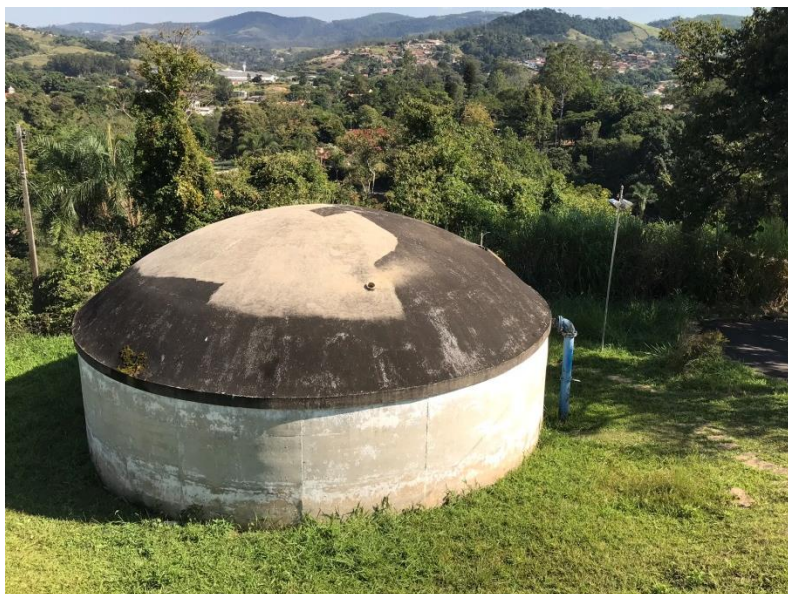
Figura 11. Reservatório de distribuição
