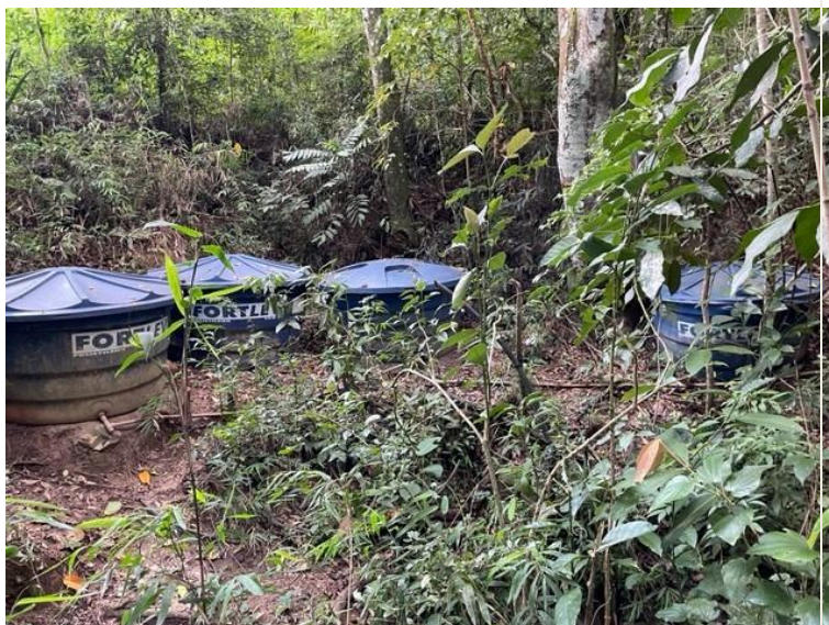
Foto 04. Caixas d'água instaladas ao longo do caminho da nascente para captação e distribuição de água para a comunidade no Parque Turístico.
