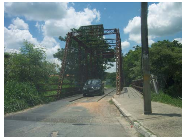
Ponte metálica de acesso ao Jardim São Dimas que deverá ser recuperada e receber tratamento específico para a circulação de bicicletas, em tráfego compartilhado com a circulação geral.
